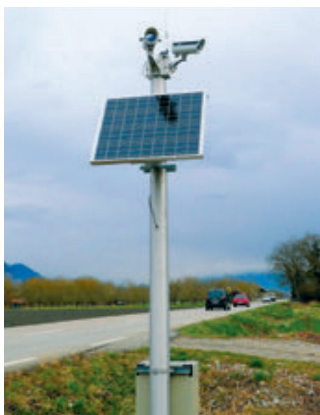
Chaque mât est alimenté par énergie solaire.
