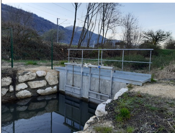
Vannes de contrôle du canal de décharge – vue amont
